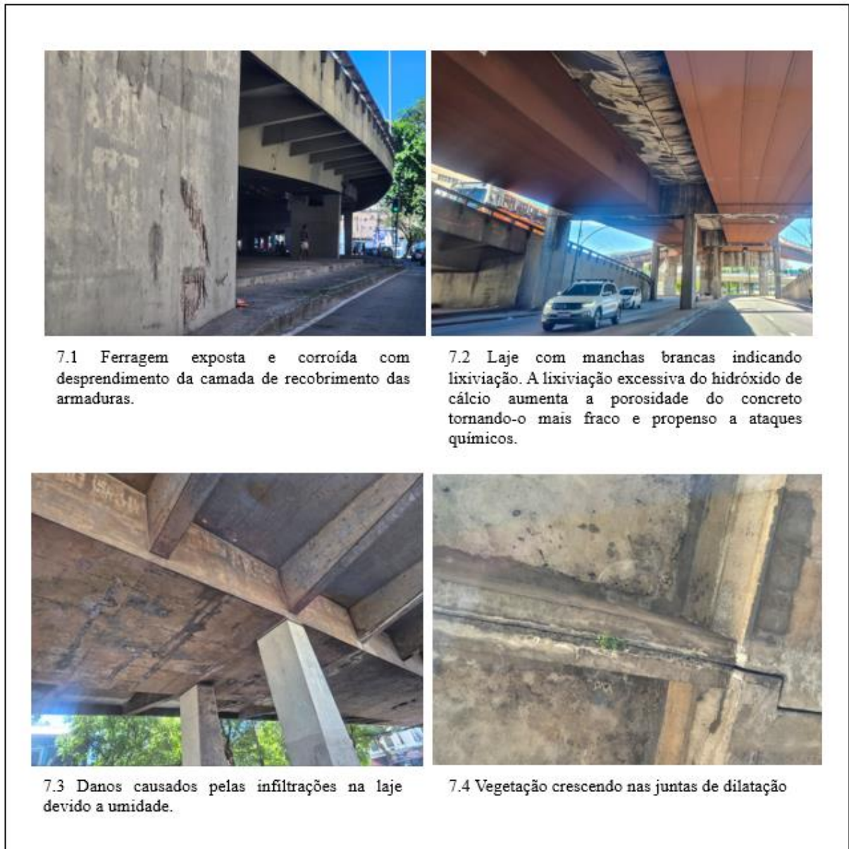
Figura 7 - Fotografias de 06/11/2024, durante visita in loco , demonstrando a situação da estrutura do viaduto:
