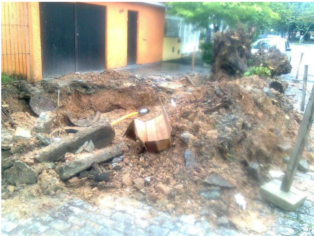
ROMPIMENTO DE TUBULAÇÃO DE GÁS DA NATURGY
